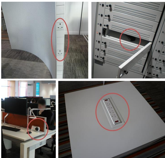
写真7 コモンズ内に設置されているコンセント類
